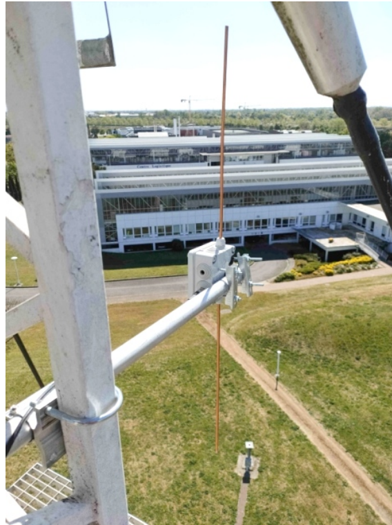
FIGURE 2.9 – Antenne dipolaire VHF fixée sur le pylône
