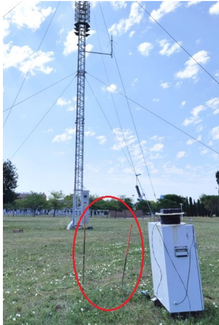
FIGURE 2.20 – Photo de la mise à la masse du générateur réalisée avec 2 pieux
