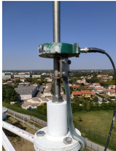
FIGURE 2.5 – Sonde de courant Pearson de conversion 0.5 V/A située sur le paratonnerre
